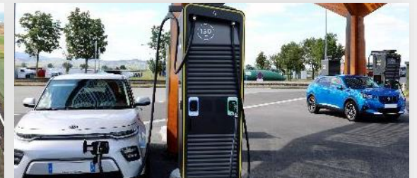
STATIONS DE RECHARGE ÉLECTRIQUE
